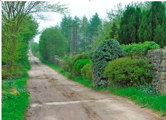
Juurdepääsutee enne – ebaühtlane ja auklik.
